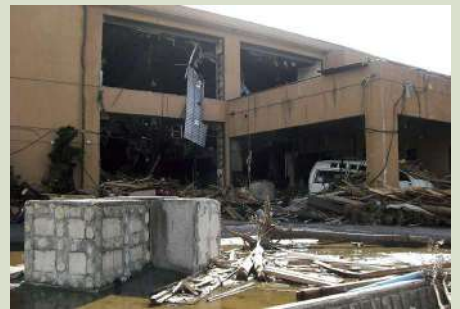
博物館の被災状況
